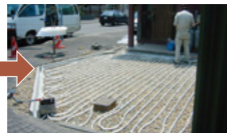
放熱管・架橋ポリパイプ敷設 ※電気式はヒーティングケーブル敷設
